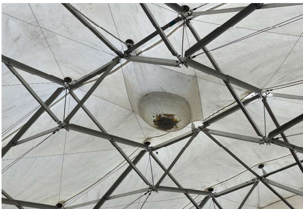
写真-3 虹のシザーズの膜で生じた「進行性ポンディング」
